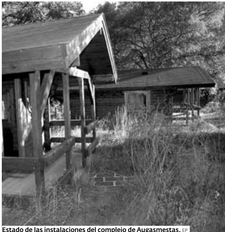
Estado de las instalaciones del complejo de Augasmestas. EP
