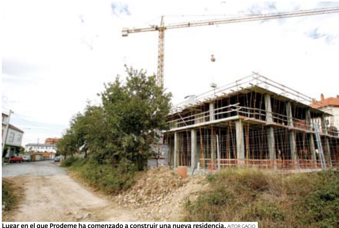
Lugar en el que Prodeme ha comenzado a construir una nueva residencia. AITOR GACIO
