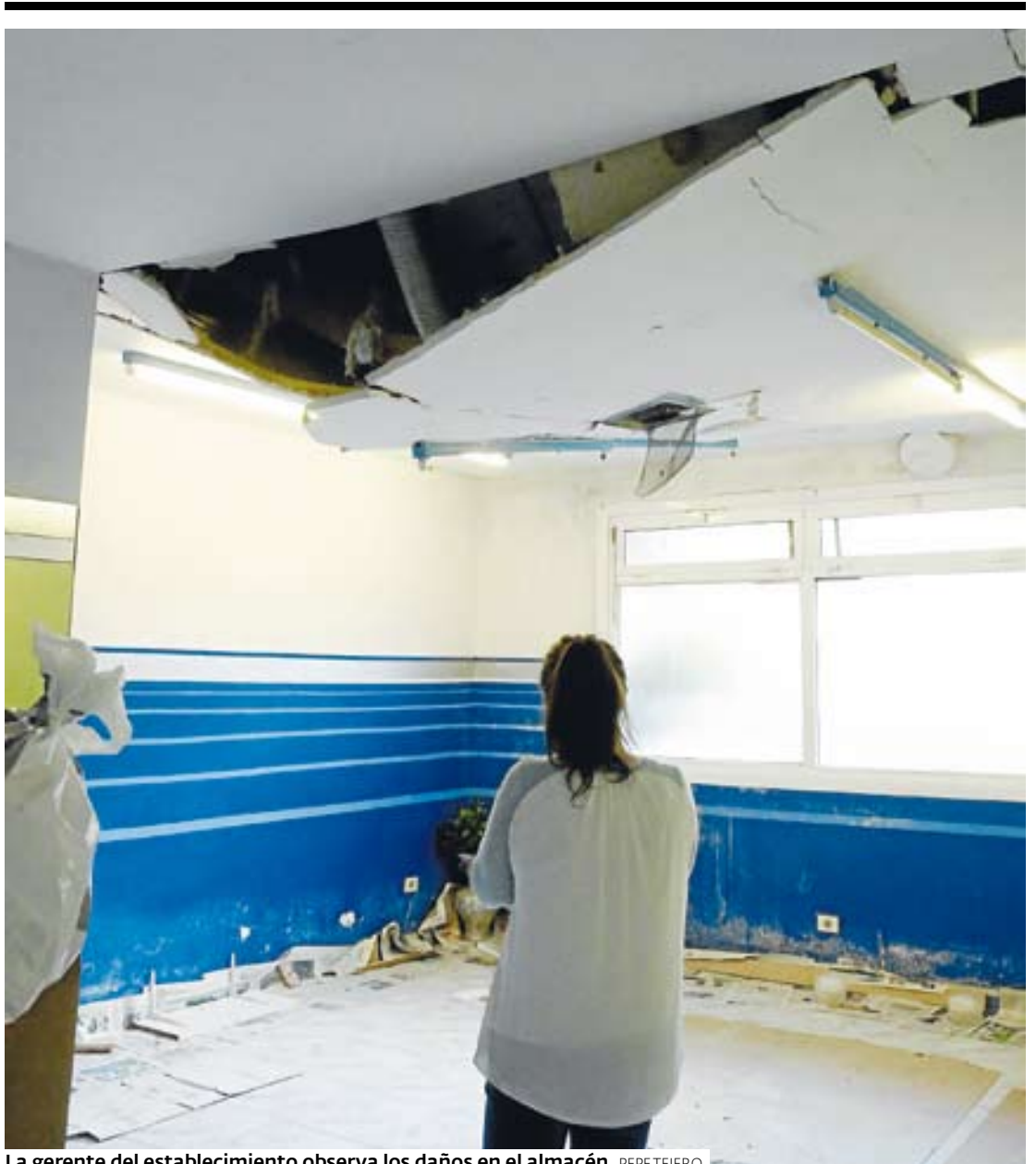
La gerente del establecimiento observa los daños en el almacén. PEPETEJERO
